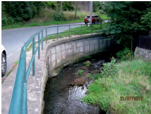
Instandsetzung Stützwand S13 im Zuge der S309-Ausgangszustand
