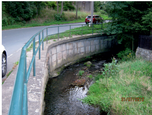
Instandsetzung Stützwand S13 im Zuge der S309-Ausgangszustand
